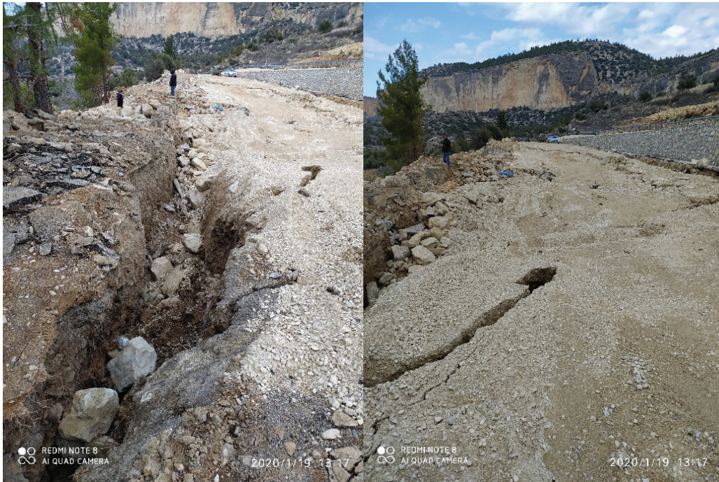
Şekil 2. Heyelanın taç kısmından bir görünüm.
